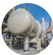
PAINEASTIAT JA KATTILAT
