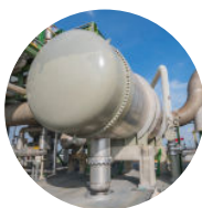
PAINEASTIAT JA KATTILAT
